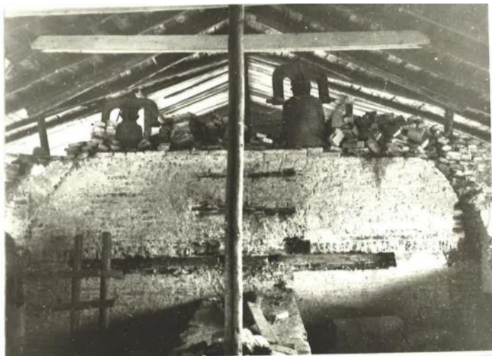
Etajul Urmle de plecare ale boltilor. Foto, arh. Ștefan Balș, 1963. Sursa: arhiva I.N.P., fond D.M.I., dos. 7045 bis
