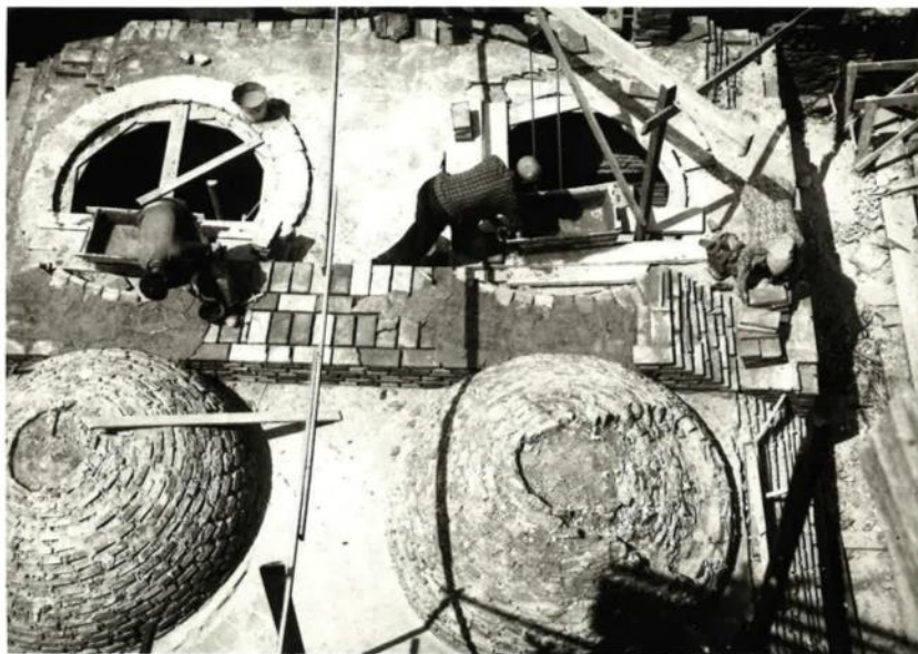
Biserica domnească din Pitești. Pronaos. Refacerea bolților. Foto, arh. Ștefan Balș, 1967. Sursa: arhiva I.N.P., fond D.M.I., dos. 7045 bis
